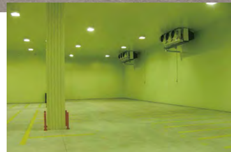
倉庫内冷凍庫
