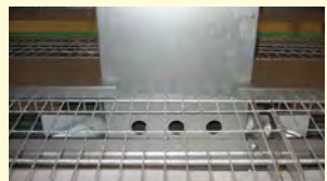
鶏糞は上部ダクトファンから吹き下ろす風を下方に伸びたダクトを通り、ファンベルトの上へ送風する。
